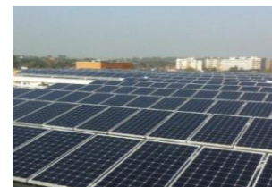
Zonnepanelen op dak
