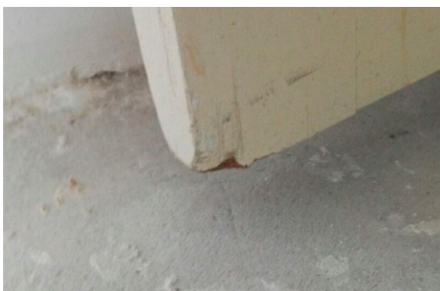
Onderkant van deur aangetast door vocht
