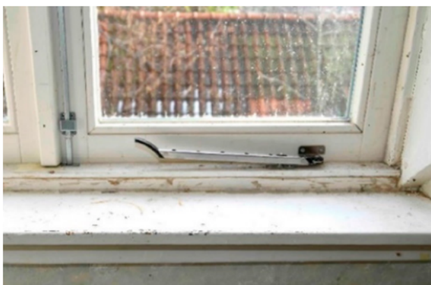
Onderkant van kozijn aangetast door vocht
