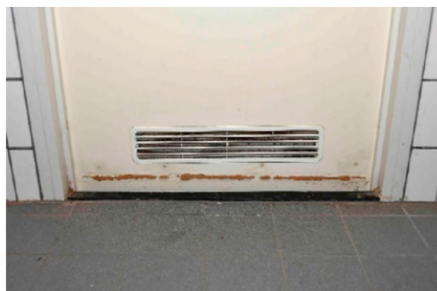
Beschadigde onderkant deur
