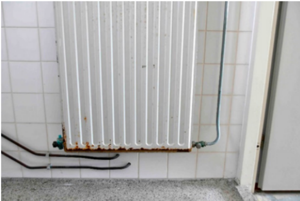
Roest niet toegestaan
