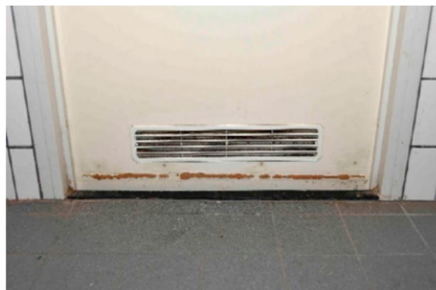
Beschadigde onderkant deur
