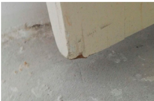
Onderkant van deur aangetast door vocht
