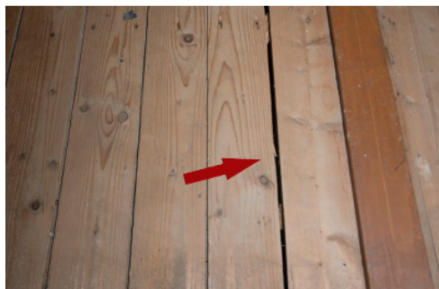
Naad in houten vloer
