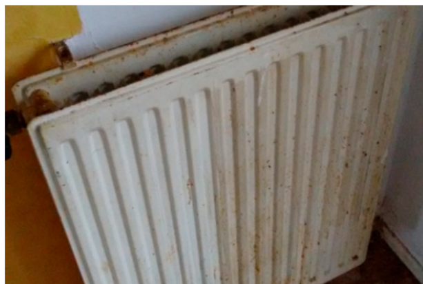
Aanslag en roest (niet meer te herstellen)
