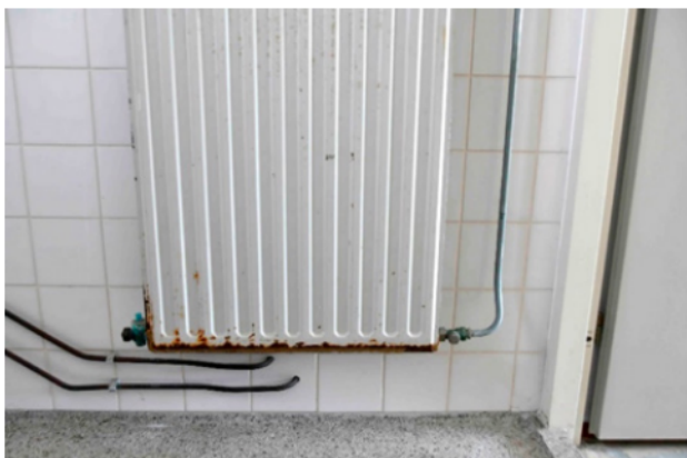
Roest niet toegestaan
