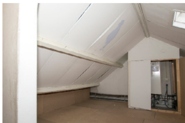
Plafondplaten sluiten niet goed aan
