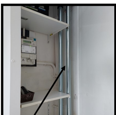
nieuwe hoofdleidingen warm -water in de meterkast
