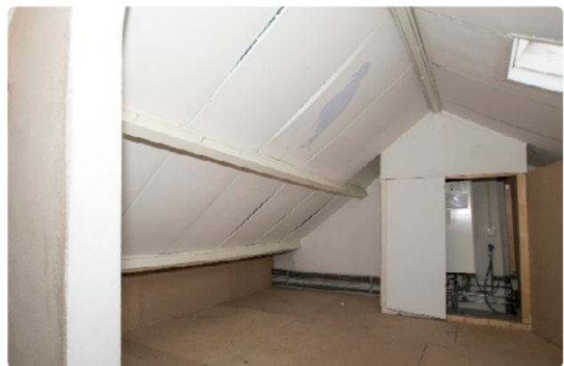
Plafondplaten sluiten niet goed aan
