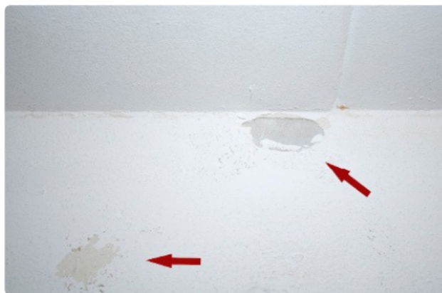
Verf of stucwerk laat los
