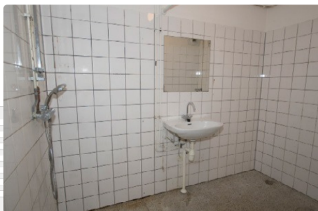
Badkamer niet goed schoongemaakt
