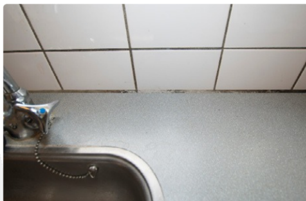
Schimmel in kitvoegen
