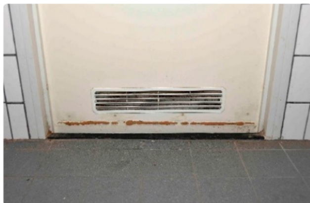
Beschadigde onderkant deur
