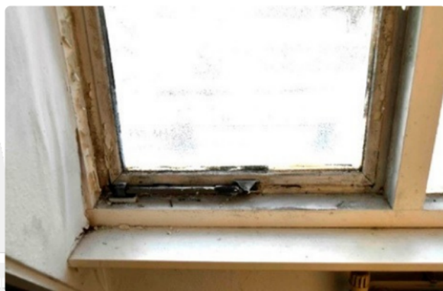
Beschadigde onderkant kozijn
