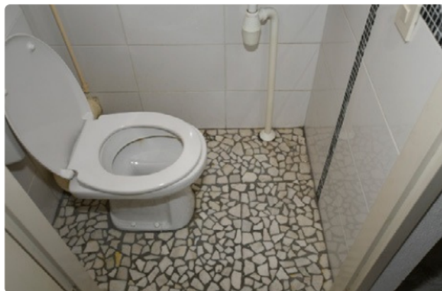
Tegelwerk niet standaard
