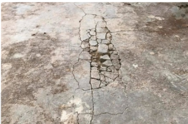
Scheur in vloer
