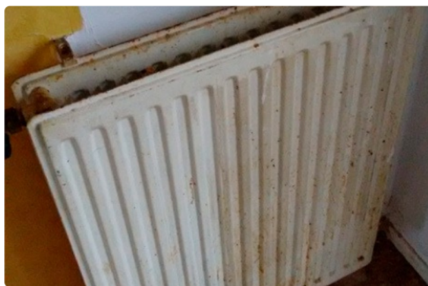
Aanslag en roest (niet meer te herstellen)
