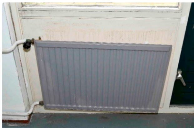
Radiator niet goed bevestigd
