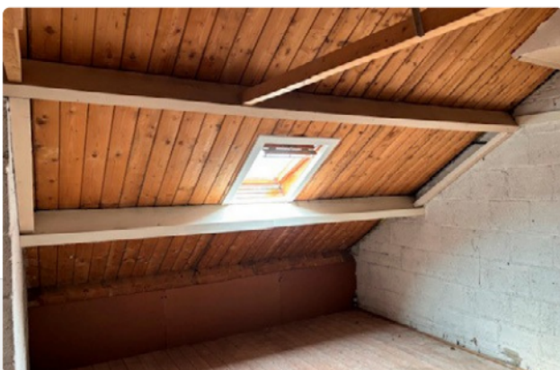
Dakafwerking in goede staat
