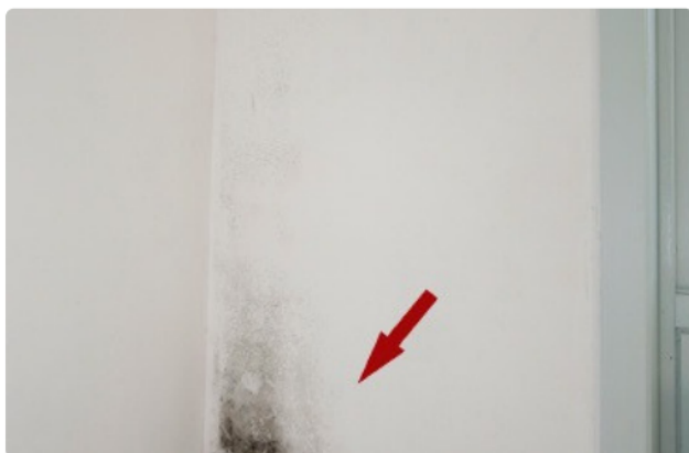
Schimmel op de muur
