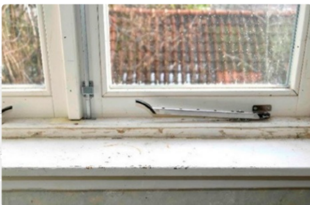
Onderkant van kozijn aangetast door vocht
