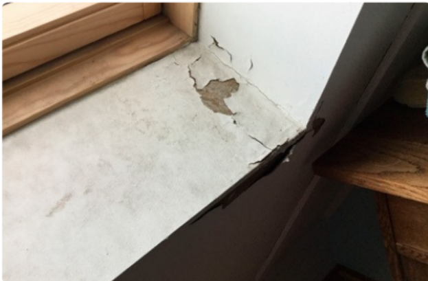
Houtwerk beschadigd door vocht (herstelschade)
