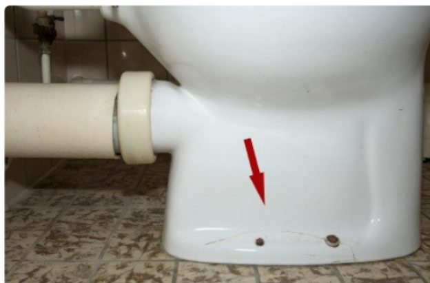
Scheur in toilet
