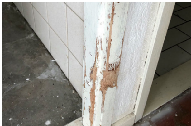
Kozijn beschadigd (herstelschade)
