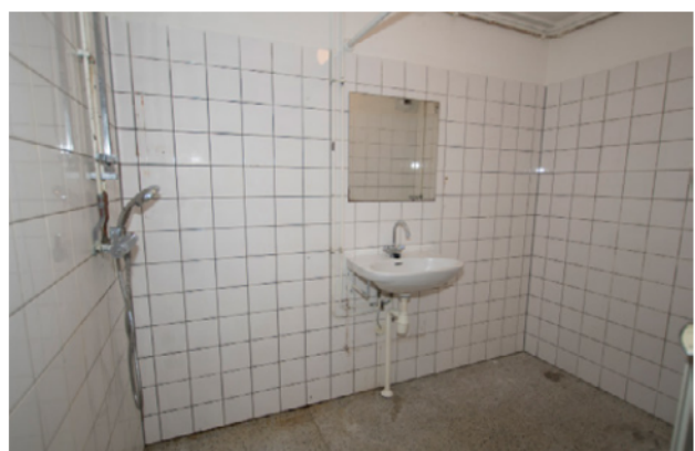
Badkamer niet goed schoongemaakt
