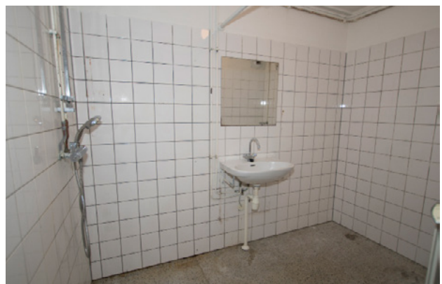
Badkamer niet goed schoongemaakt
