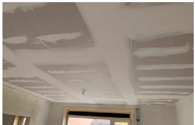
Nieuwe gipsplaten zijn dichtgesmeerd en schilderklaar
