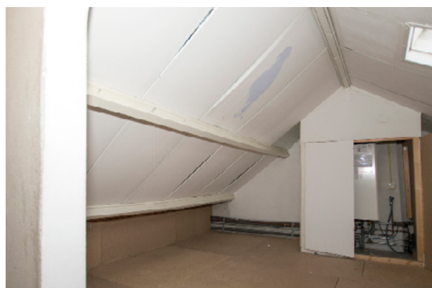
Plafondplaten sluiten niet goed aan
