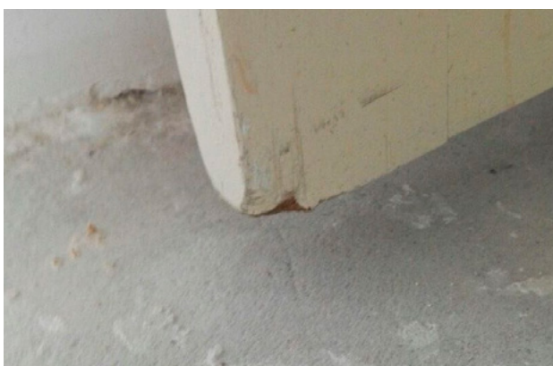
Onderkant van deur aangetast door vocht
