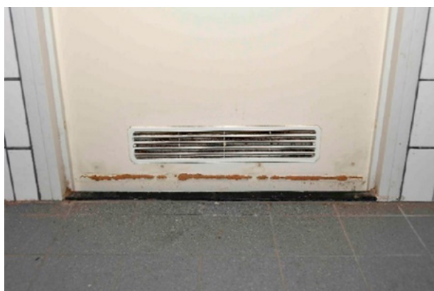
Beschadigde onderkant deur
