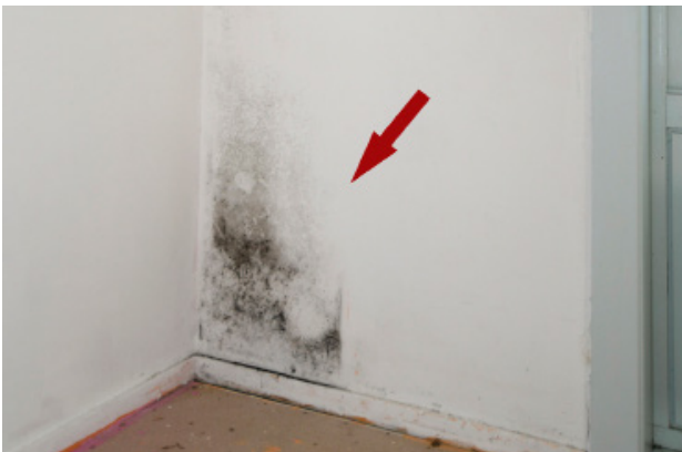
Schimmel op de muur
