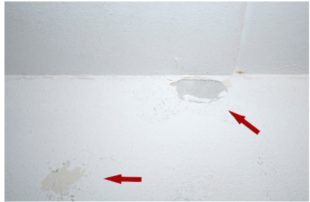
Verf of stucwerk laat los
