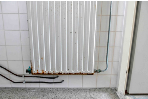
Roest niet toegestaan
