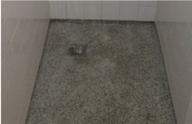
Kalkaanslag op de vloer
