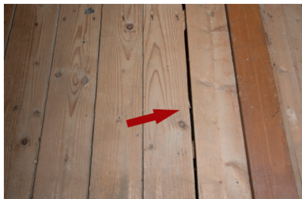
Naad in houten vloer
