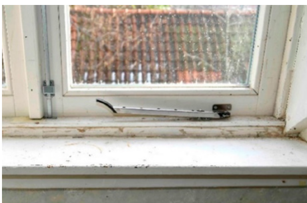
Onderkant van kozijn aangetast door vocht
