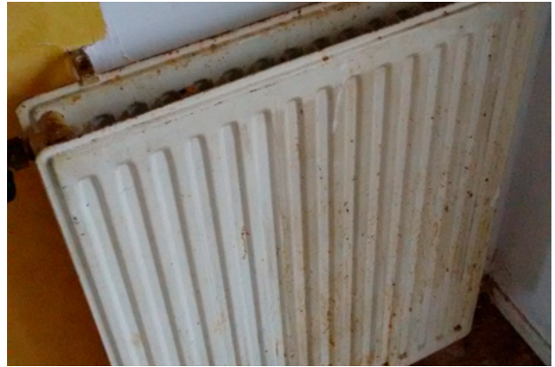
Aanslag en roest (niet meer te herstellen)
