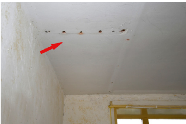
Gaten in het plafond
