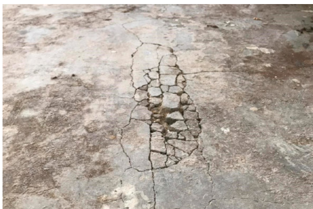
Scheur in vloer
