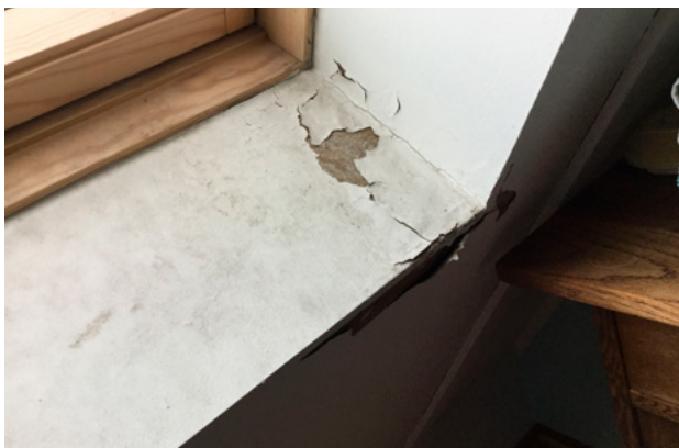
Houtwerk beschadigd door vocht (herstelschade)
