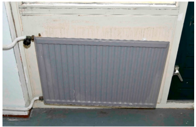
Radiator niet goed bevestigd
