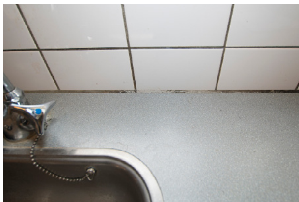
Schimmel in kitvoegen
