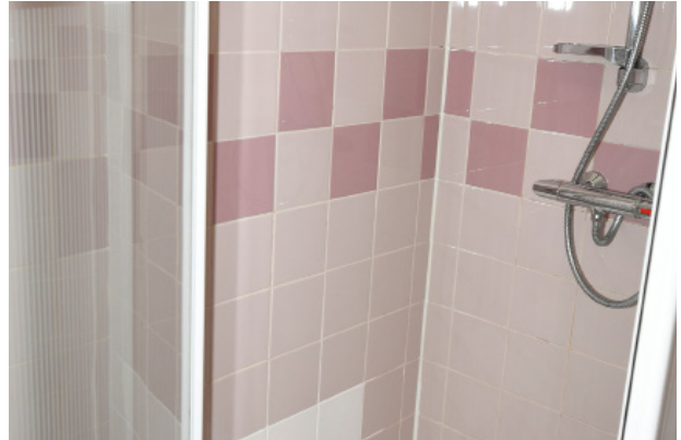
Kleurverschil in de tegels en voegwerk
