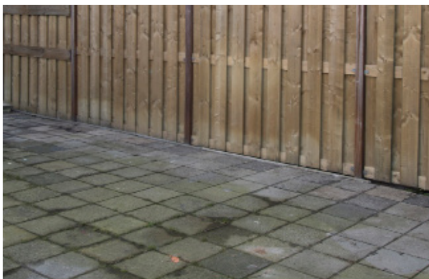
Verkleuringen in tegels
