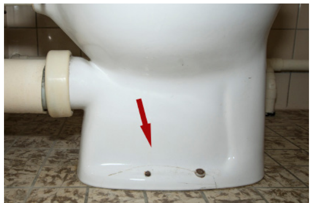
Scheur in toilet
