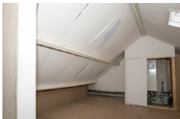
Plafondplaten sluiten niet goed aan
