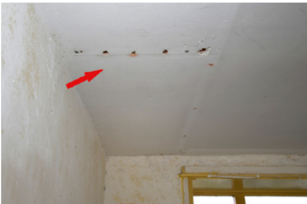
Gaten in het plafond
