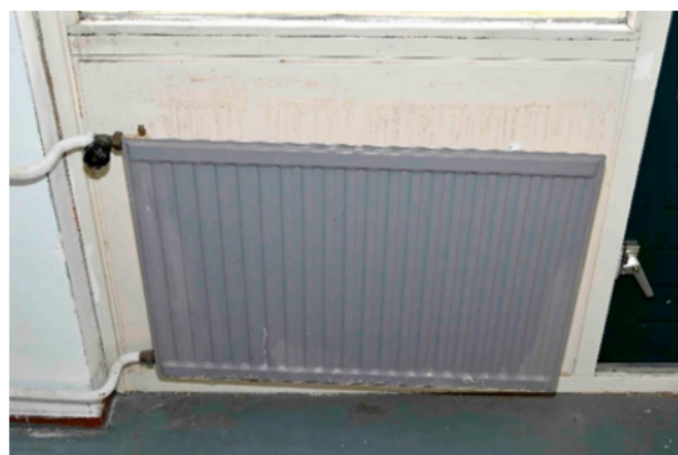
Radiator niet goed bevestigd
