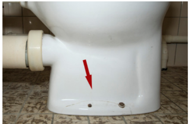
Scheur in toilet
