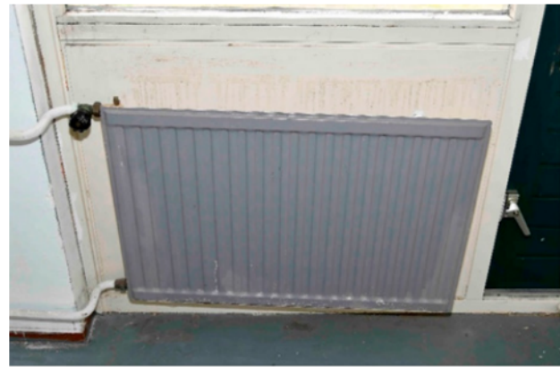
Radiator niet goed bevestigd
