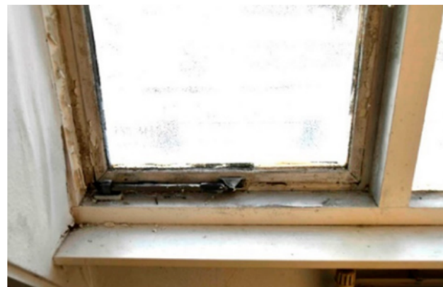
Beschadigde onderkant kozijn
