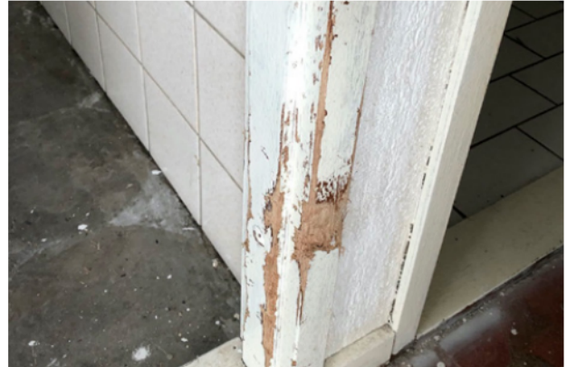
Kozijn beschadigd (herstelschade)
