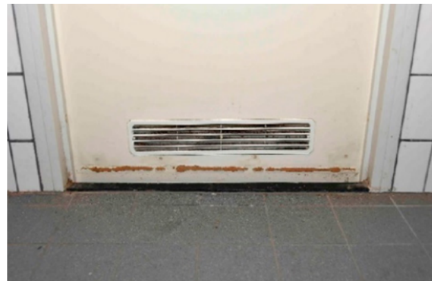
Beschadigde onderkant deur
