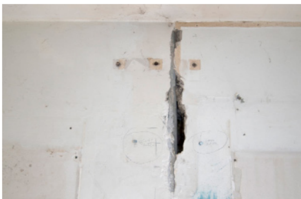
Gaten in de muur
