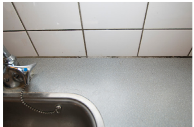
Schimmel in kitvoegen
