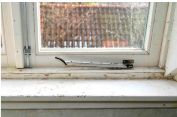
Onderkant van kozijn aangetast door vocht
