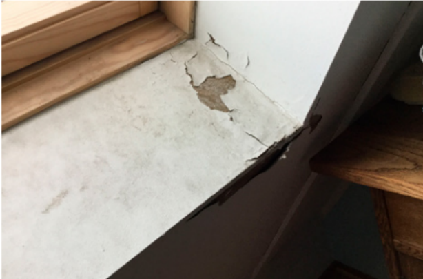
Houtwerk beschadigd door vocht (herstelschade)
