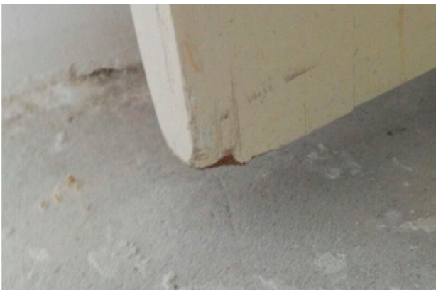
Onderkant van deur aangetast door vocht
