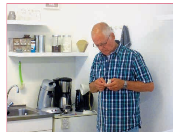
Meneer Besselink maakt het lampje in de keuken van een RSWP-cliënt. Omdat de stekker niet veilig was, heeft hij er meteen een nieuwe stekker op gezet. Veiligheid voor alles.
