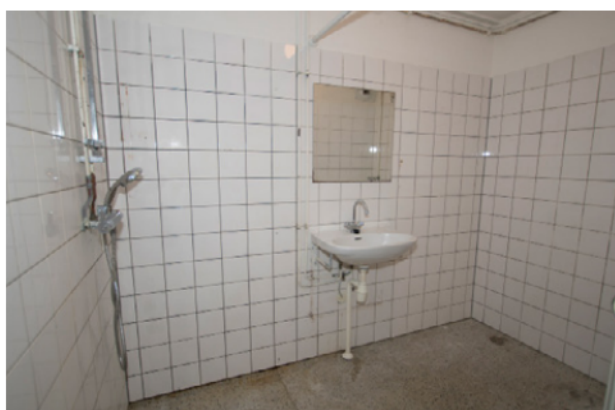
Badkamer niet goed schoongemaakt
