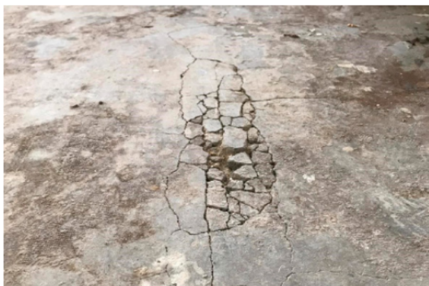
Scheur in vloer
