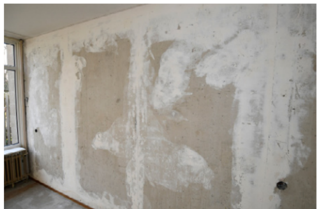
Betonnen wand (kleine luchtballen kunnen aanwezig zijn)
