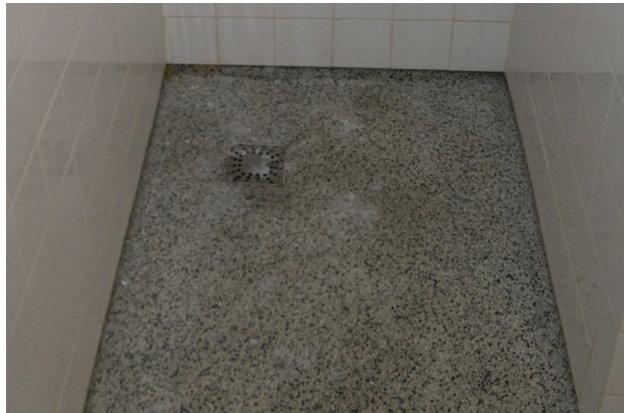
Kalkaanslag op de vloer
