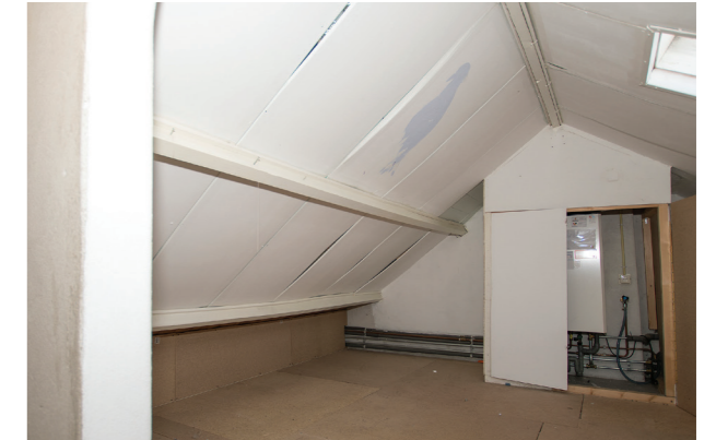
Plafondplaten sluiten niet goed aan
