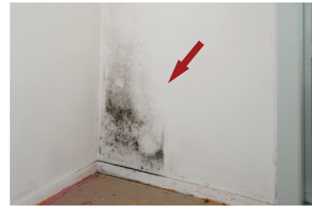
Schimmel op de muur
