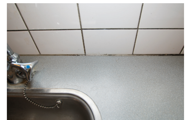
Schimmel in kitvoegen
