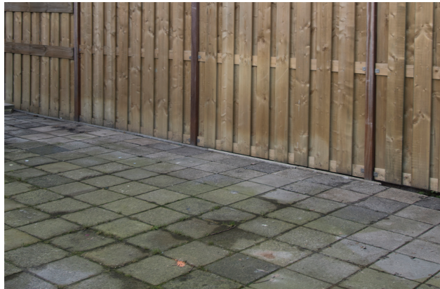
Verkleuringen in tegels
