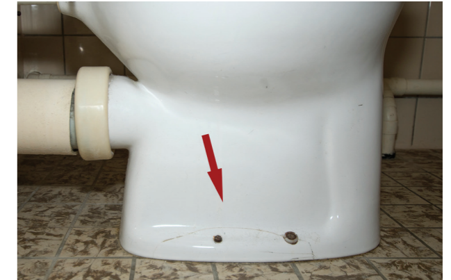
Scheur in toilet
