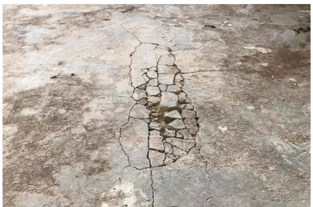
Scheur in vloer
