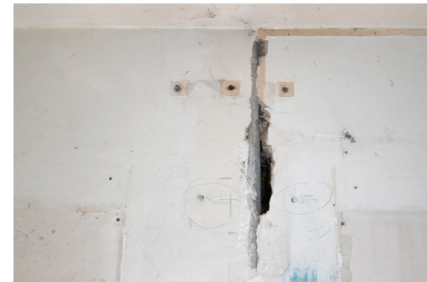
Gaten in de muur
