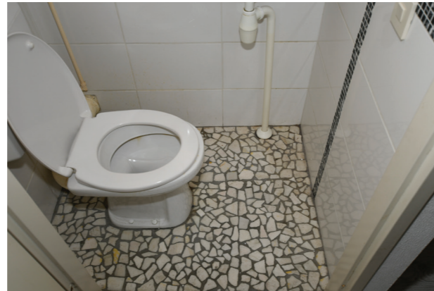
Tegelwerk niet standaard
