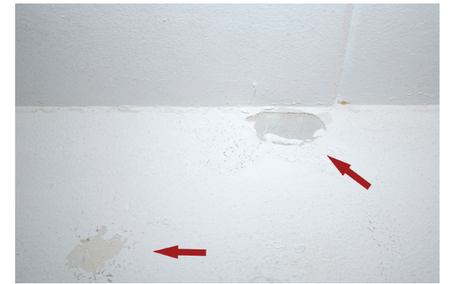
Verf of stucwerk laat los
